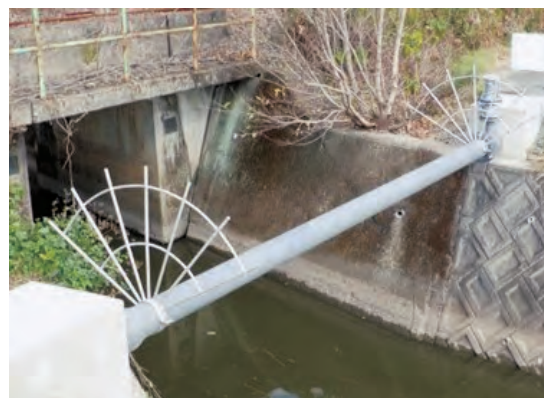
川をまたぐ水道管（上）
