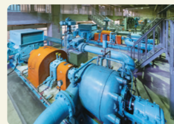
送水ポンプ設備、電気計装設備、第一・第二調整池、中継ポンプ場、送水管(φ1,000~150mm L=85.7km)等
