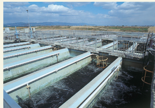
活性炭接触池 活性炭を混ぜることで、においを取り除きます。
