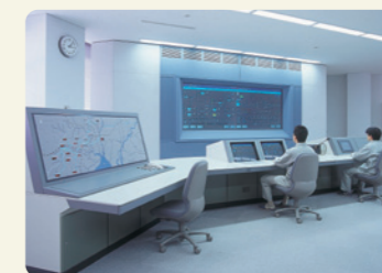
監視制御設備、計装設備、情報処理設備
