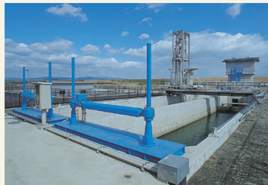
沈砂池 大きな砂や土などを沈めて取り除くところです。
