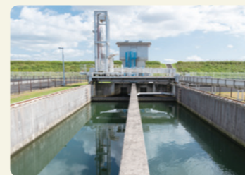
取水口、取水樋管、沈砂池、導水ポンプ設備等
